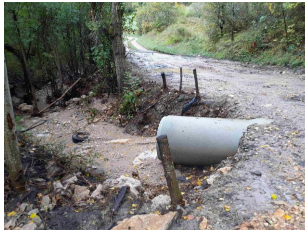
Dégradation du passage busée de Comayras 26 octobre 2023
