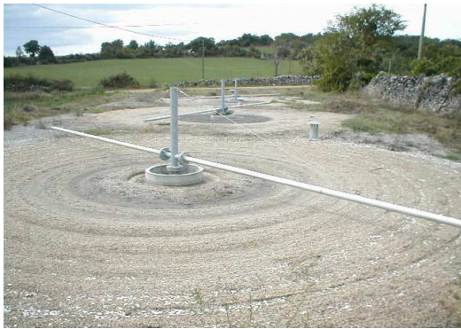
Les trois filtres à sables avec les rampes
