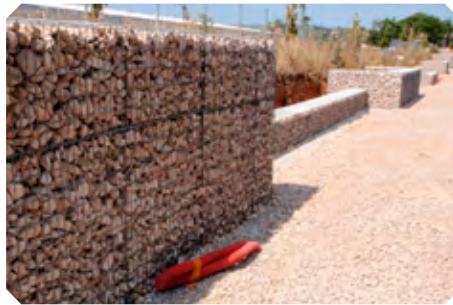
Gabions soutenant le pied de talus. La grille en acier galvanisé s'accorde avec la clôture arrière (ZA La Cavalerie).
