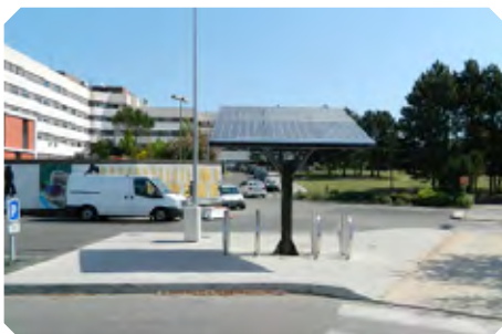
Abris vélos photovoltaïque sur le Centre Hospitalier de Villefranche-sur-Saône (69)
