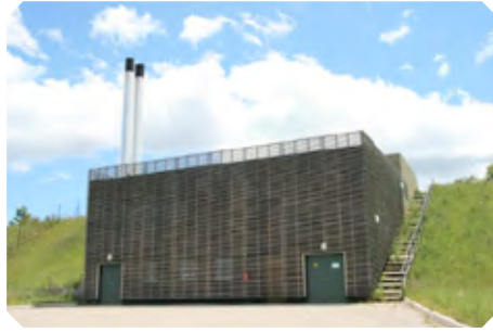
Exemple de chaufferie bois alimentant un réseau de chaleur (ZAC du Crozatier à Saint-Flour – 15)
