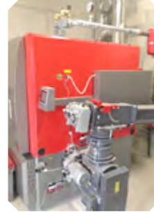
Chaudière à bois déchiqueté installée dans les locaux de l'entreprise Sévigné TP à Aguessac
