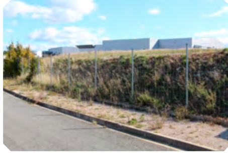
Dans ce cas, l'implantation de la clôture en bas du talus rend difficile toute intervention d'entretien sur le talus.
