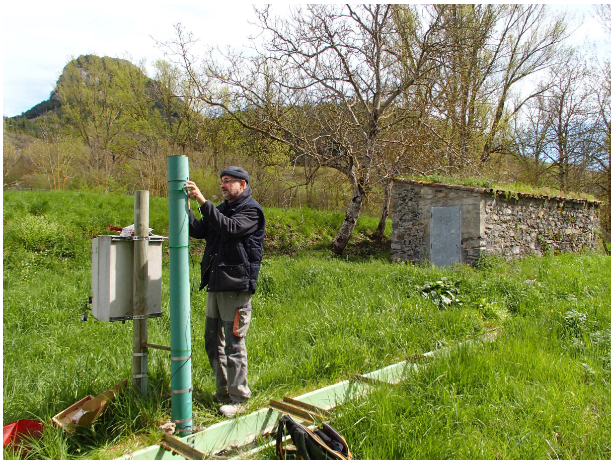
Remplacement de la roue codeuse au captage de Tendigues
